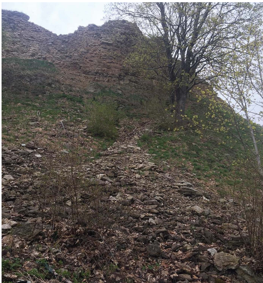
Рис. 3. Совместное выветривание и осыпание склона и стен Копорской крепости Fig. 3. Joint weathering and crumbling of the slope and walls of the Kopper fortress
