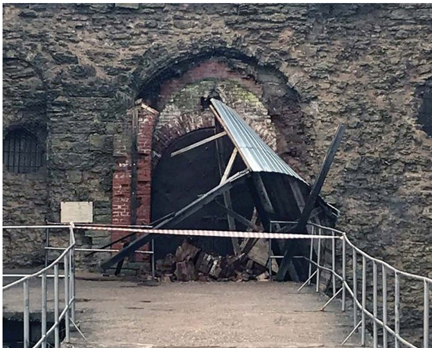
Рис. 4. Обрушение защитного козырька в крепости Копорье [21]
