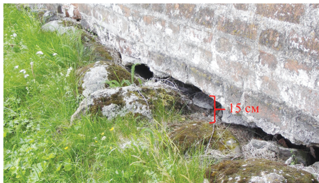
Рис. 1. Деформации крепостной стены Нового города
