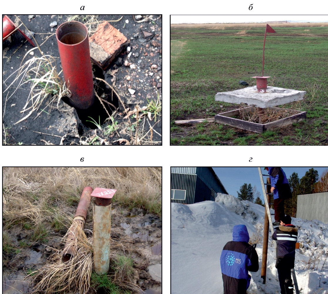
Рис. 3. Нарушения конструктивных элементов наблюдательных скважин, спроектированных без учёта климатических особенностей и гидрогеологических условий района: а – разрушение бетонной отмостки; б, в, з – выпирание обсадной колонны в результате сезонных циклов промерзания-оттаивания горных пород
