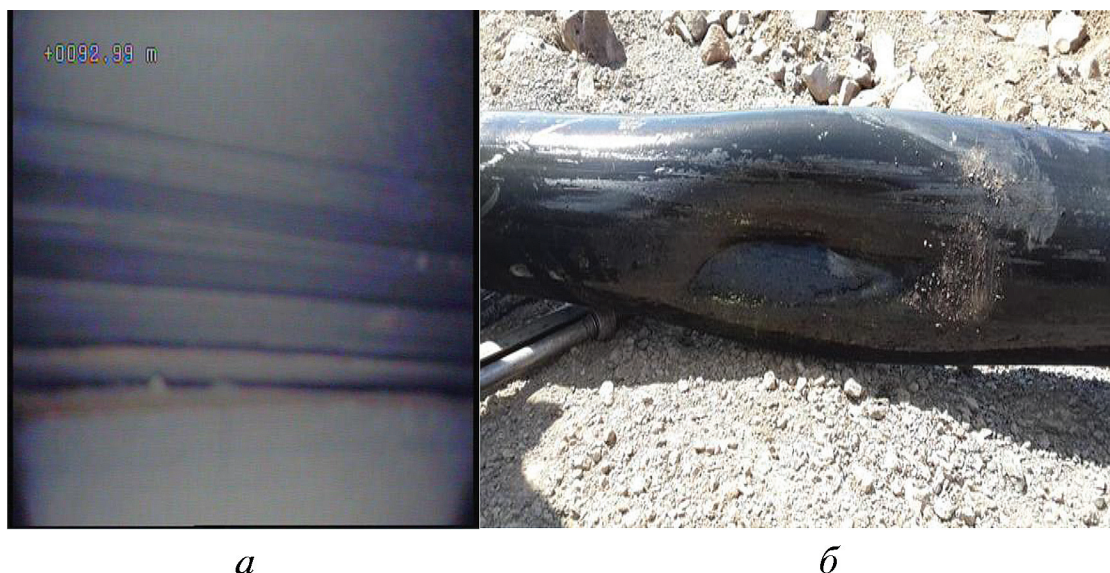
Рис. 2. Дефекты обсадных колонн из труб ПНД: а – изгиб обсадной колонны; б – смятие трубы ПНД при замерзании воды в заколонном пространстве
