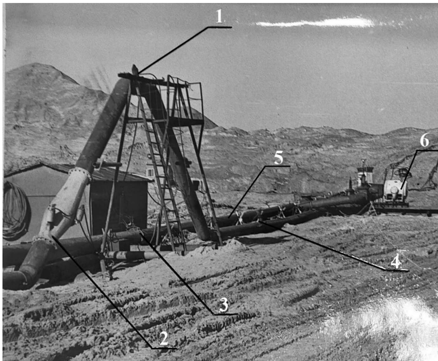
Рис. 4. Общий вид установки системы определения расхода и плотности гидросмеси: 1 — гидростатический плотномер; 2 — расширяющее устройство расходомера гидросмеси; 3 — диафрагма ДК-25-450; 4 — пульпо-вод Двнутр = 410 мм; 5 — водовод Двнутр = 450 мм; 6 — водяной насос 300Д-90
